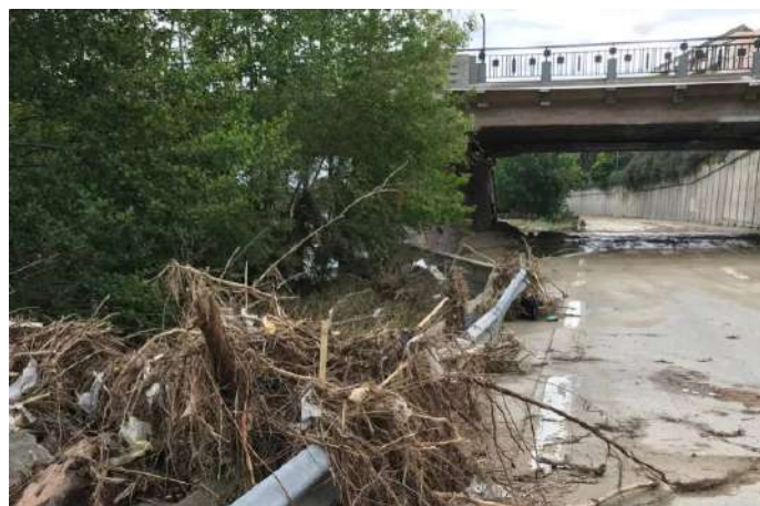
Illustration 30 : Berges de la Têt suite à la crue de janvier 2020 (source : francetvinfo.fr)
