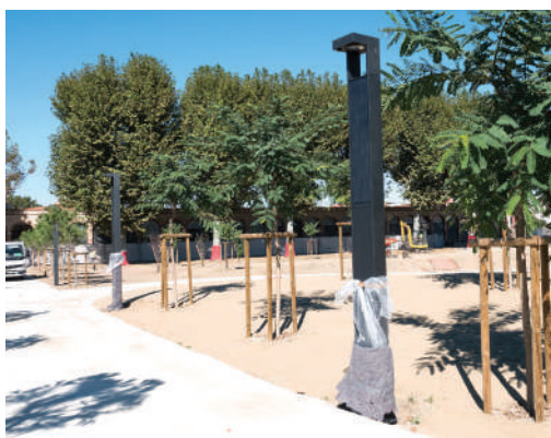
Éclairage solaire des allées du parc
